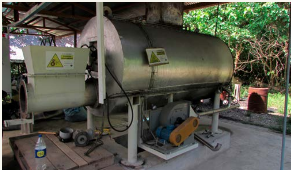
Foto 11: Equipo industrial, pirolizador de flujo continuo. Fuente: Archivo CINCIA, 2018.
